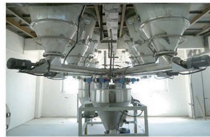
Additives Weigher Katkı Maddeleri Tartım İstasyonu
